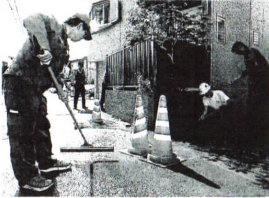
地震の影響で水道管が壊れた現場。各地で水道管の補修に かかる費用は増大している＝昨年9月、東京都調布市で
